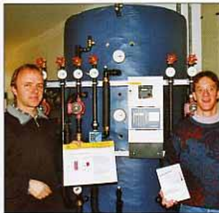
Jenni AG liefert auf Wunsch auch fixfertig verrohrte und verdrahtete Speicheranlagen nach Kundenwünschen. Martin Neuhaus, Mitglied der Geschäftsleitung (links) und Daniel Marti zeigen die bei jeder Anlage mitgelieferte umfassende Dokumentation wie Schema und Funktionsbeschreibung.
